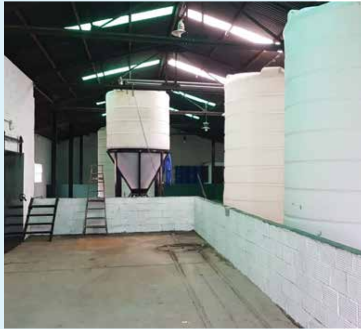
Planta de acopio y tratamiento de aceite vegetal usado de la cooperativa.
