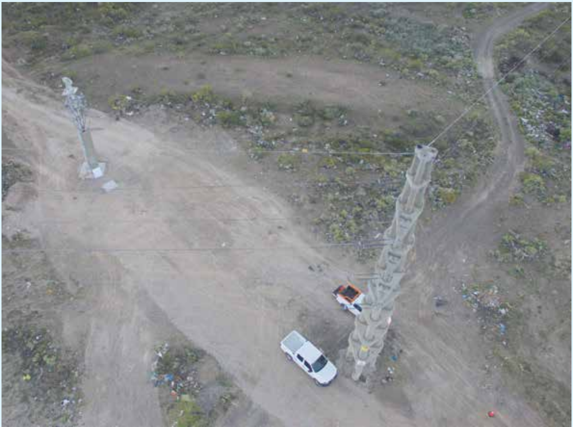
Vista aérea del tendido que posee una a capacidad de transmisión de 30 MVA.
