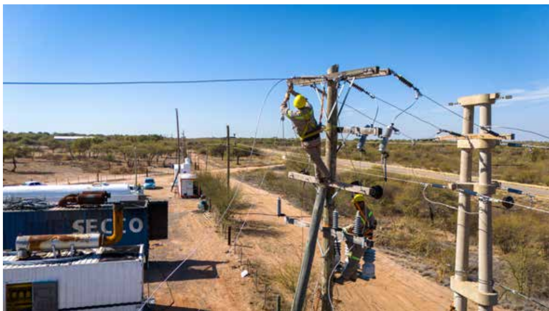
Operario de Edelar vinculando Chepes II con LMT.
