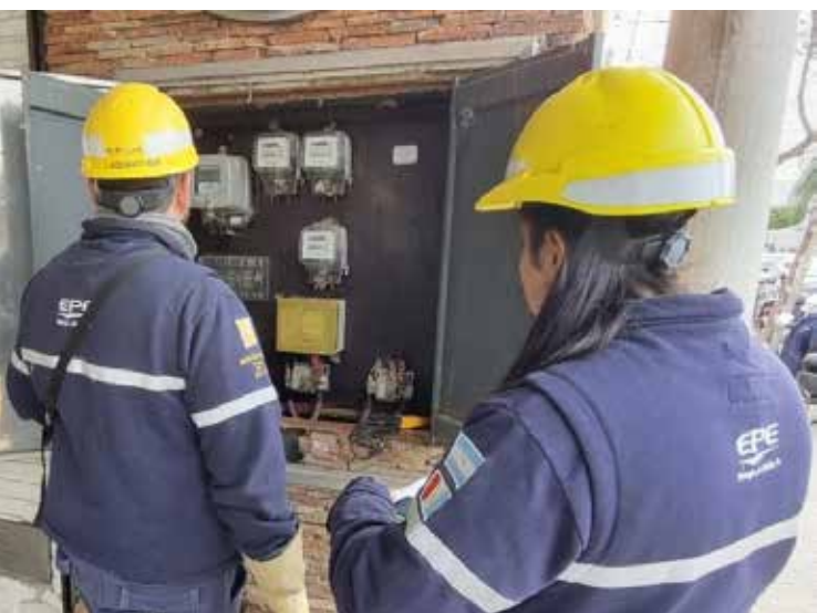
La empresa instaló 2.664 equipos de telemedición en la provincia de Santa Fe.
