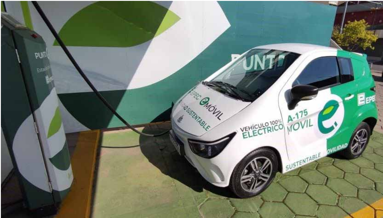
Punto de carga para vehículos eléctricos, ubicado en el edificio central de Epec.
