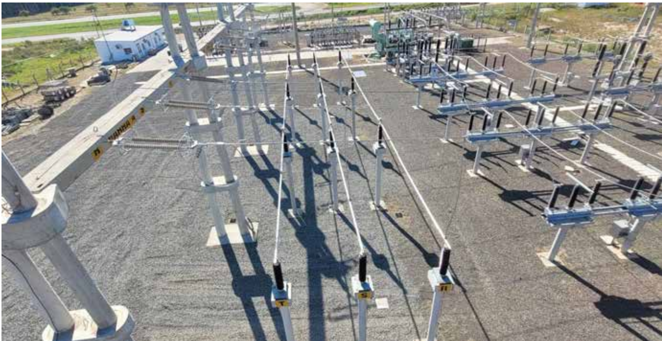
La estación transformadora “Mocoretá” tiene una superficie total de 9.760 metros cuadrados.
