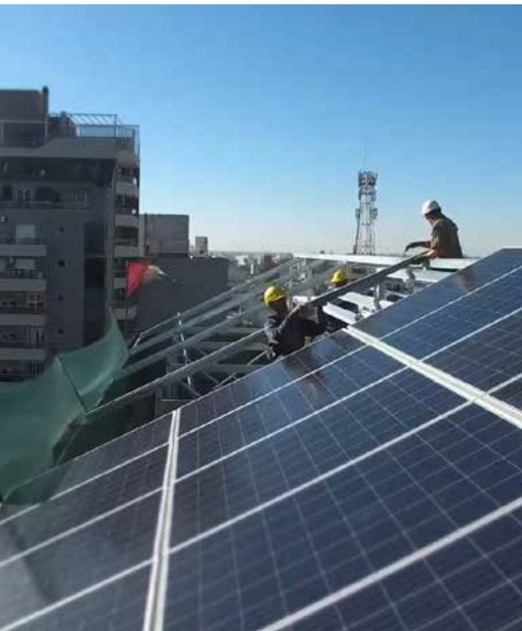
Epec instaló paneles solares en su edificio administrativo y en centrales generadoras.
