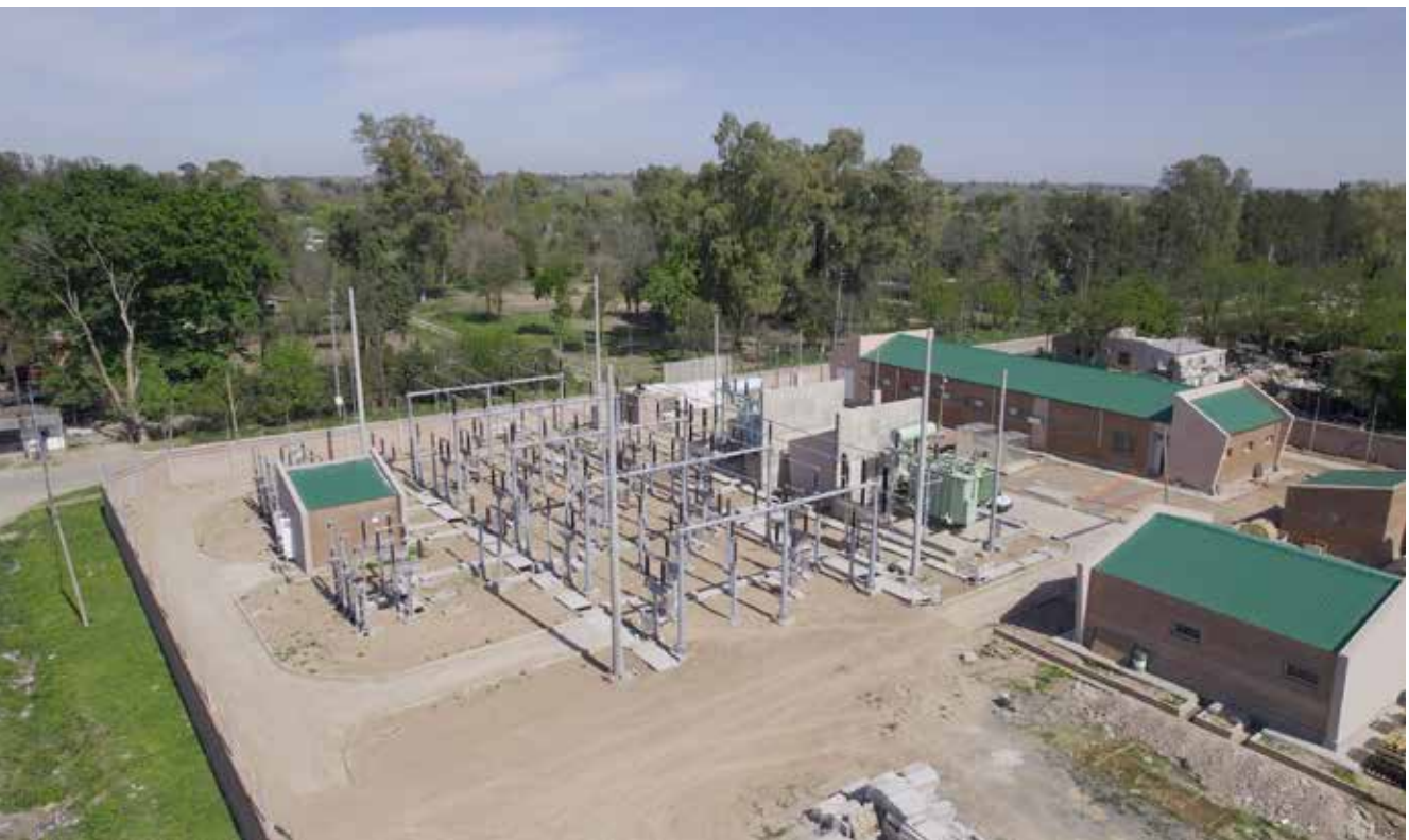
Playa de maniobras de la nueva subestación.
