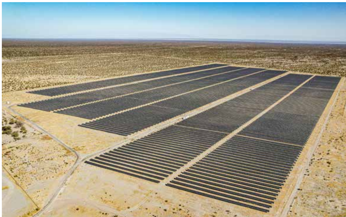
Parque solar ubicado en el oeste de la provincia de Catamarca.
