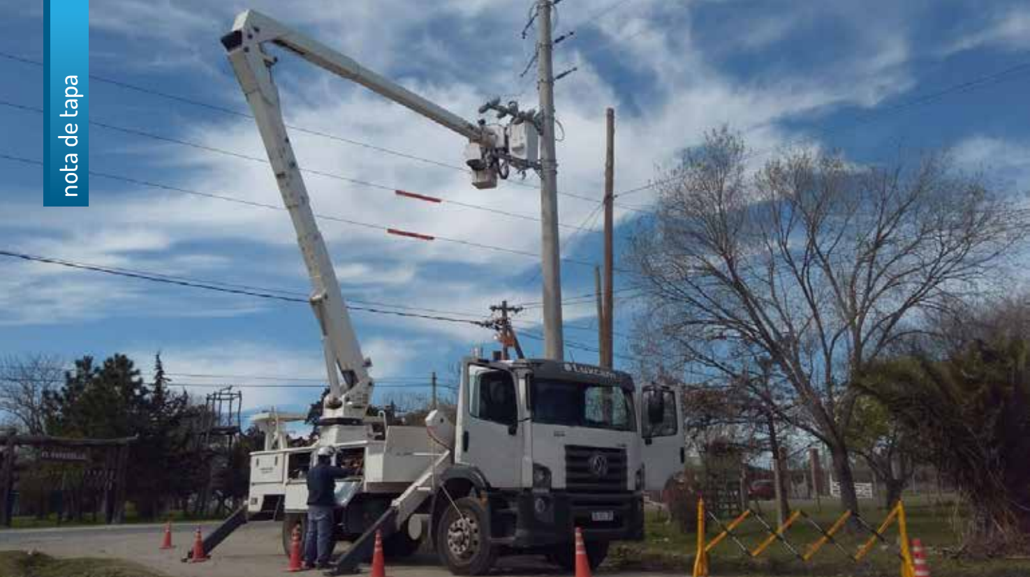
Las distribuidoras de energía eléctrica apuestan constantemente a renovar su infraestructura.
