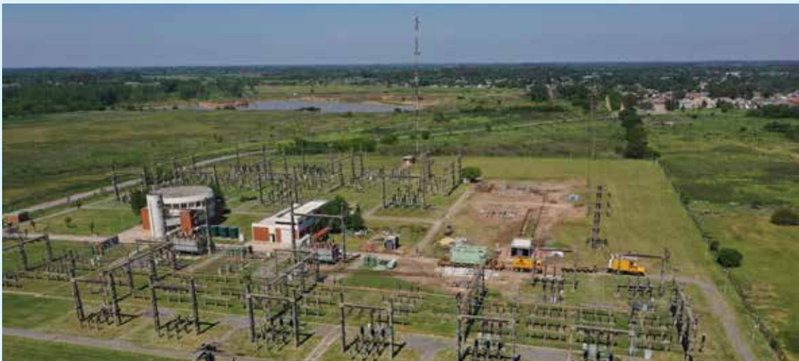
Subestación Bosques, ubicada en la Zona Sur del Gran Buenos Aires.
