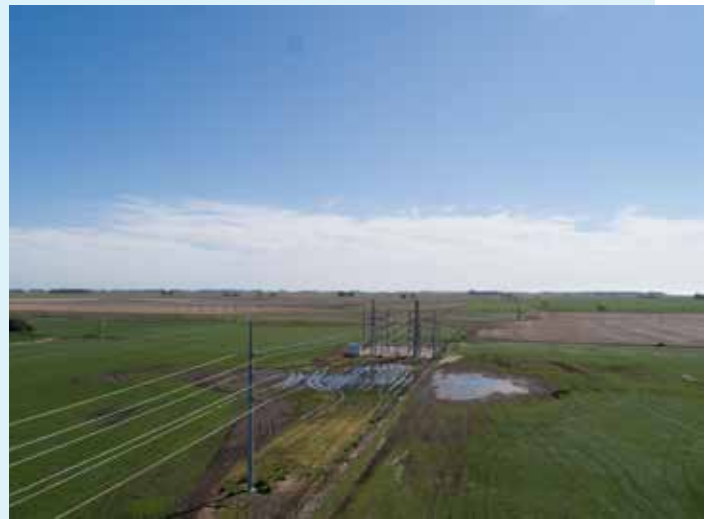
Línea 132 kV Santa Clara - Mar del Plata.
