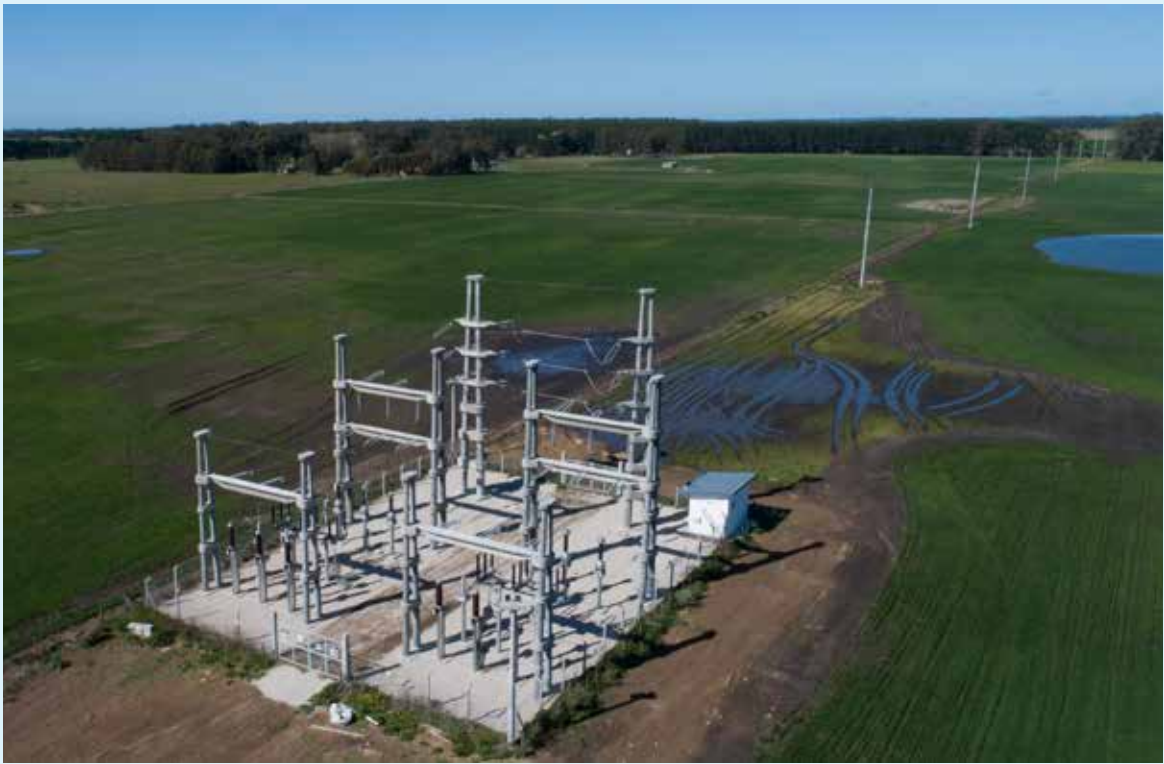
Plataforma línea 132 kV Santa Clara - Mar del Plata.
