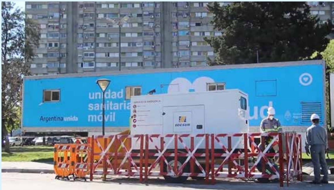
Edesur realizó la conexión eléctrica en consultorios móviles ubicados en Villa Lugano.
