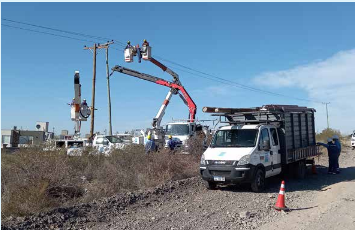
Trabajos de Edemsa luego de las ráfagas de Zonda.
