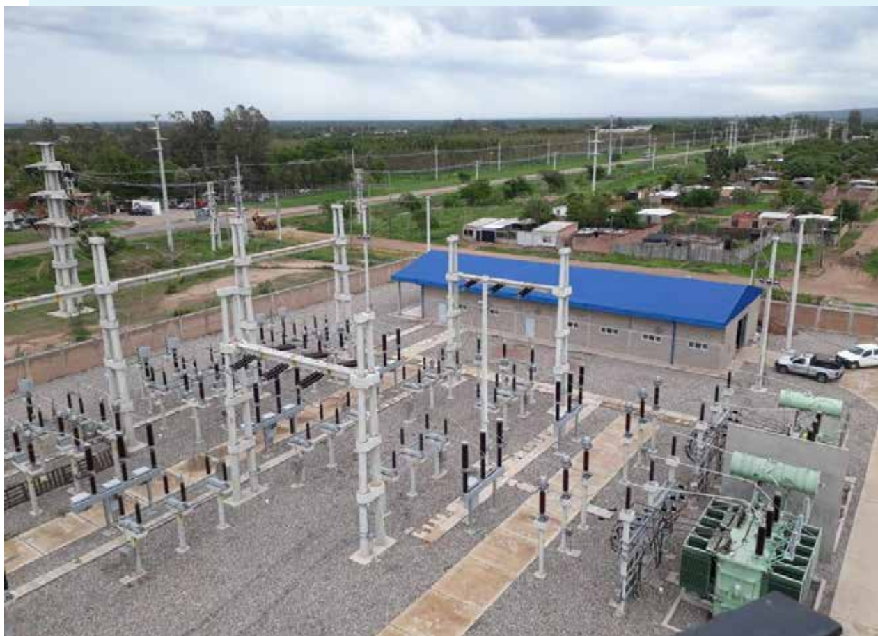
Nueva Estación Transformadora Pichacanal.
