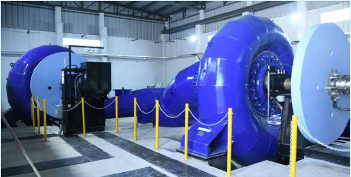
Las centrales hidroeléctricas se operan de forma totalmente remota y automatizada.
