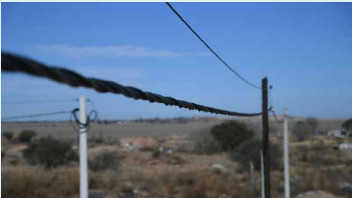
El objetivo principal es otorgar mayor seguridad para los usuarios y para la red que distribuye la energía eléctrica.
