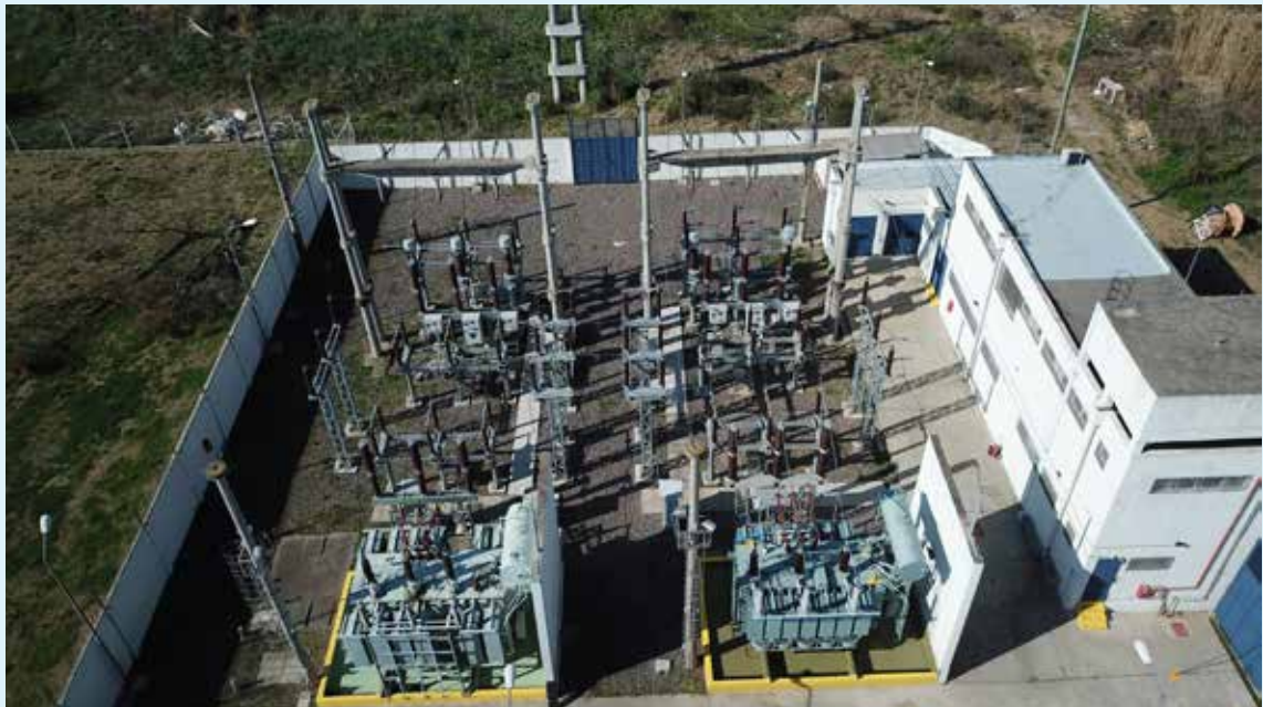
La Subestación Sur está emplazada en la calle 139 entre 89 y 90.
