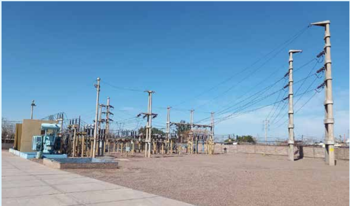
Estación Transformadora Maipú.
