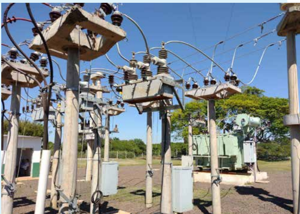
Estación Transformadora (ET) de 33/13,2 kV en la localidad de San Carlos.
