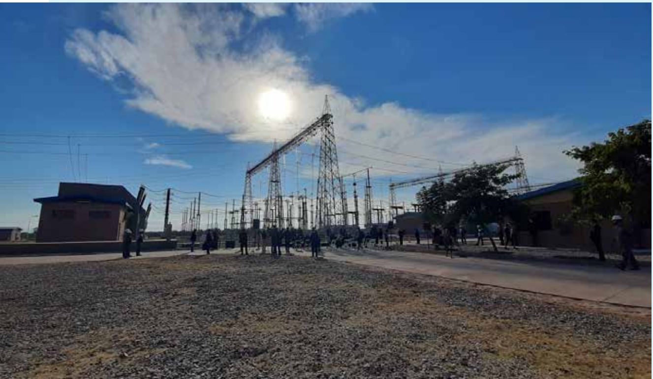
Estación transformadora de 500 KV La Rioja Sur, El Estanquito.
