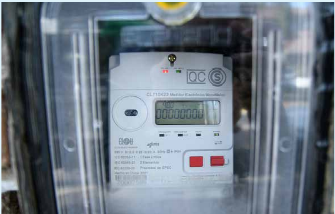
La empresa proyecta instalar 200 mil medidores inteligentes a clientes particulares.
