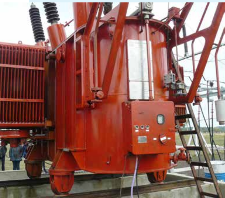
Estación Transformadora sobre Ruta Nacional 12 (km 748).
