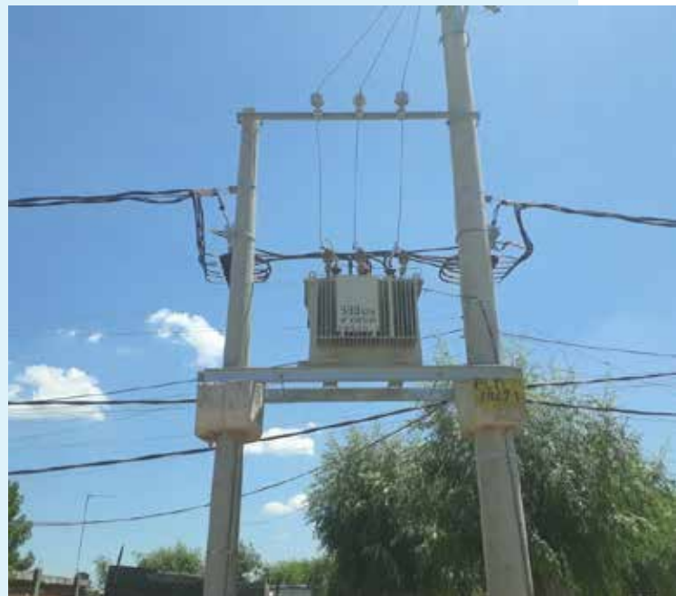
Aumento de potencia a 500 KVA en el Barrio 9 de Enero de la localidad de Esteban Echeverría
