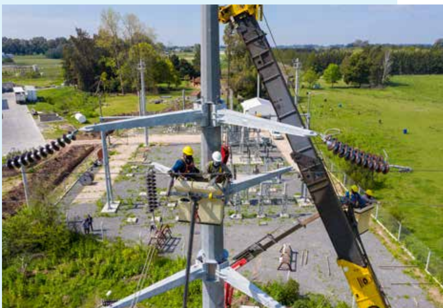
Subestación Bavio, emplazada en General Mansilla (Ruta 54 km 8), partido de Magdalena.
