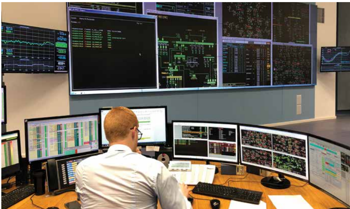
Centro de control de operaciones de Cammesa en la ciudad de Pérez, Santa Fe.
