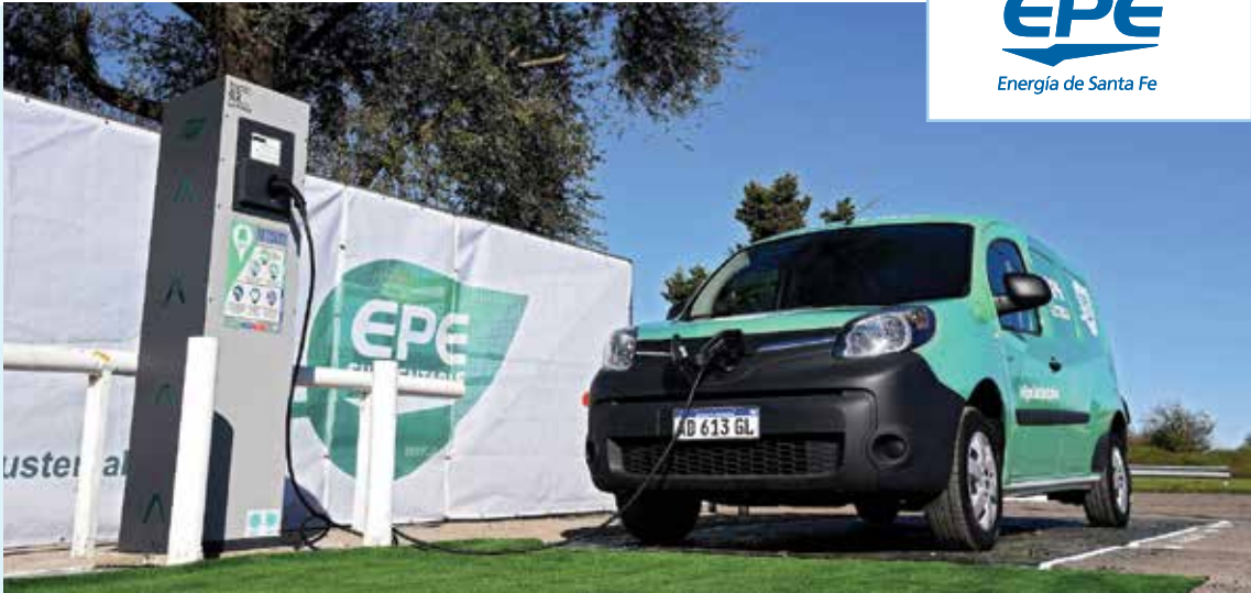
Estación de carga para vehículos eléctricos desarrollado por la EPESF.
