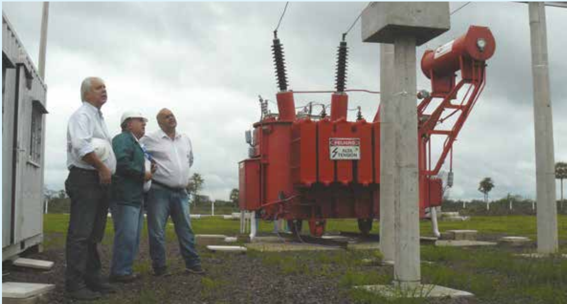
Estación Transformadora 132/33/13,2 kV "Paso Tala".
