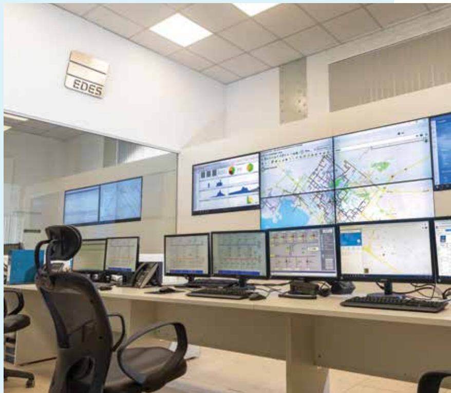
Centro Operativo de Distribución de la empresa EDES.
