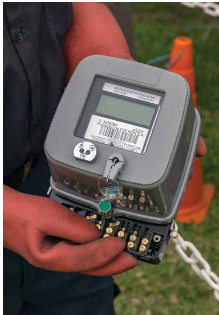
Medidor que se utilizó en la primera instalación.
