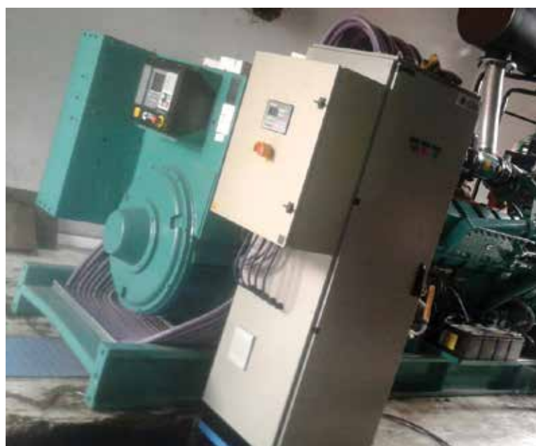
Grupo electrógeno instalado.
