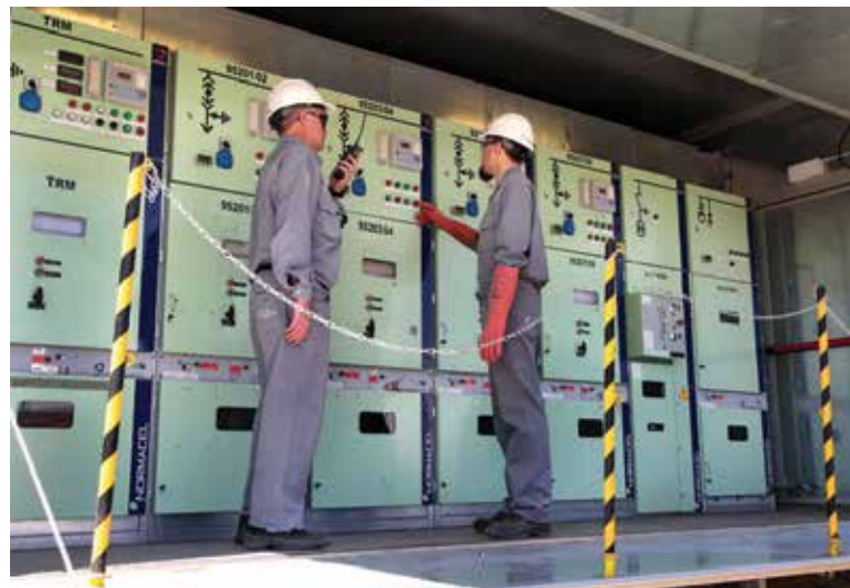
Subestación móvil Puesto Roca.
