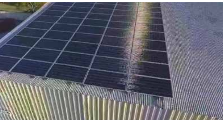
Paneles solares instalados en la planta de SIASA, en el Parque Industrial.
