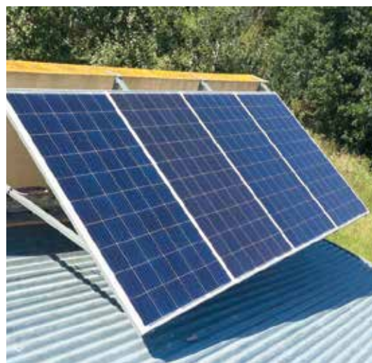
Panel instalado en el techo de un jardín de infantes.
