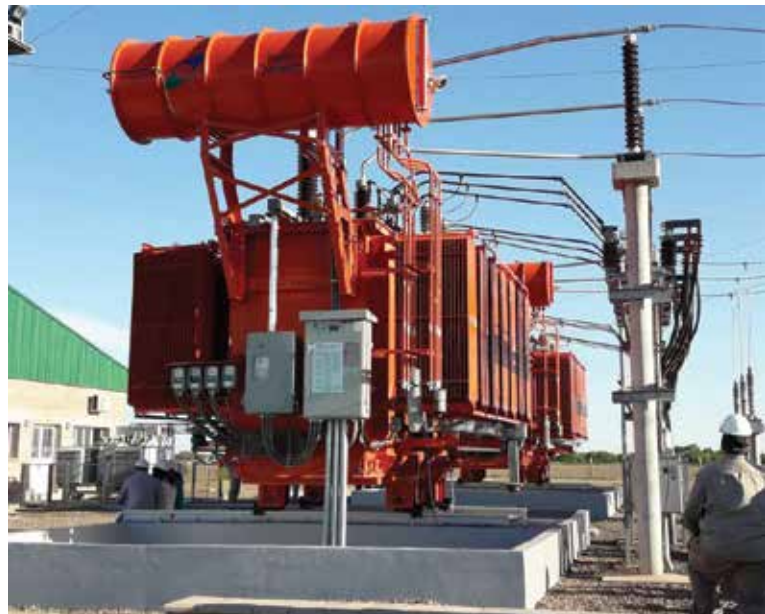
La nueva Estación Transformadora beneficiará a 50.000 usuarios.
