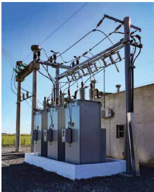
Nuevos reguladores de tensión de 33 KV, Roque Pérez.
