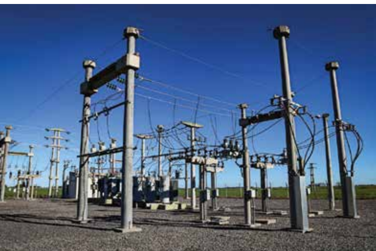
Ampliación de la Estación Transformadora Roque Pérez II.
