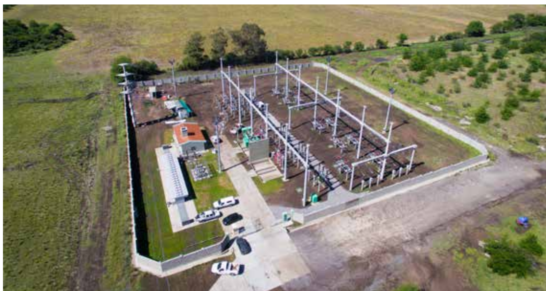
Estación Transformadora Mendiolaza.
