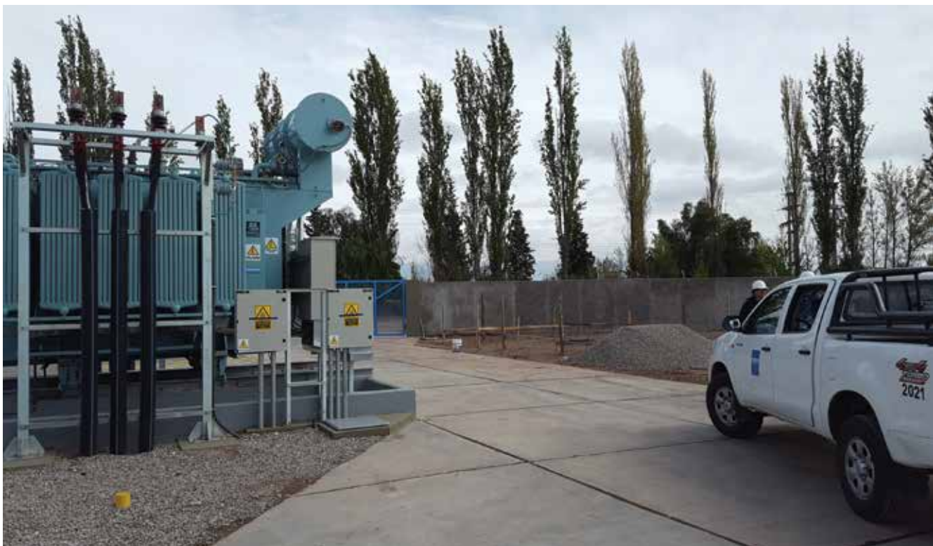
Trafo de la Estación Transformadora El Cerrito.
