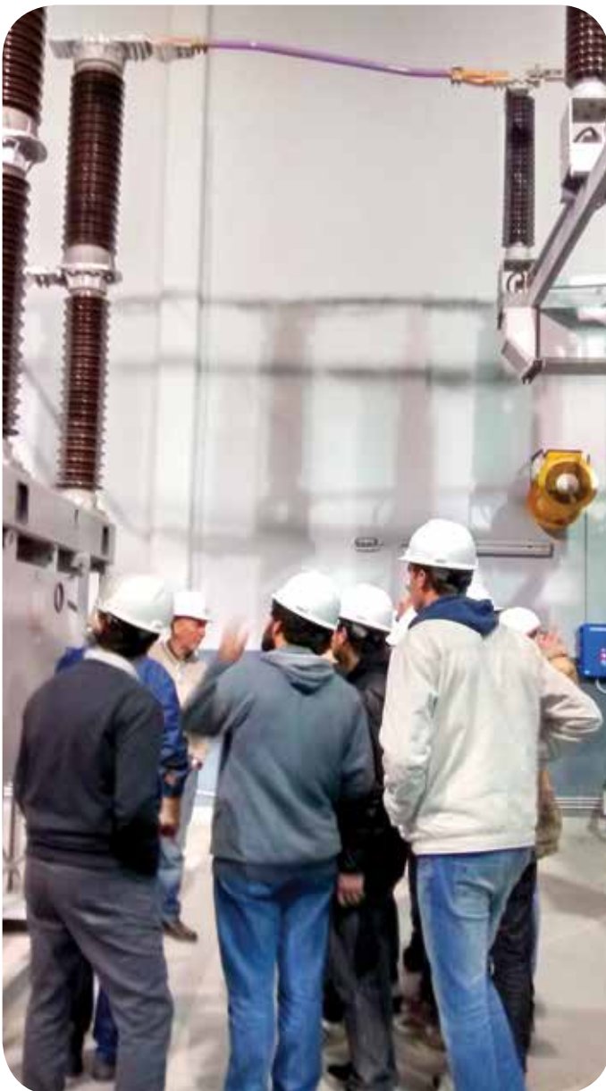
Recorrido por las instalaciones de la estación transformadora de la zona sur de la ciudad de Mar del Plata.
