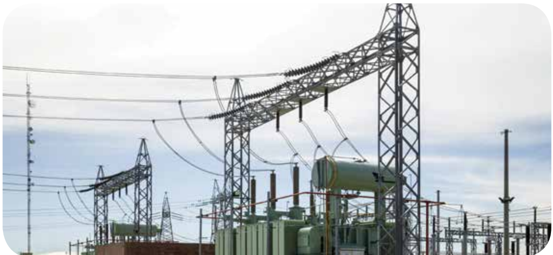
Transformadores de 220/132 kV y 300 MVA.
