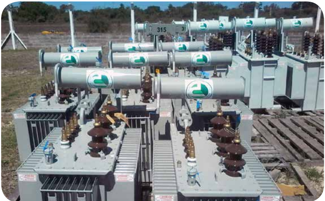
Transformadores de 315 KVA.
