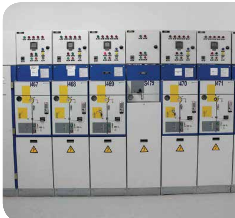
Instalaciones de la SE N° 502.
