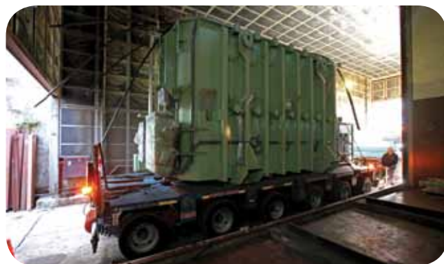
El nuevo transformador brinda mejor servicio a 500.000 vecinos
