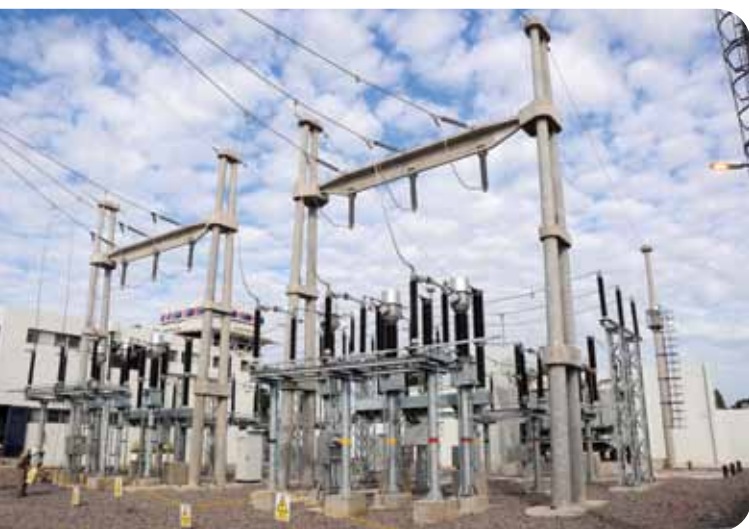
Nueva Subestación Sur.
