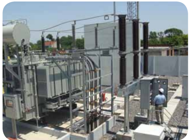
Nueva Subestación Este
