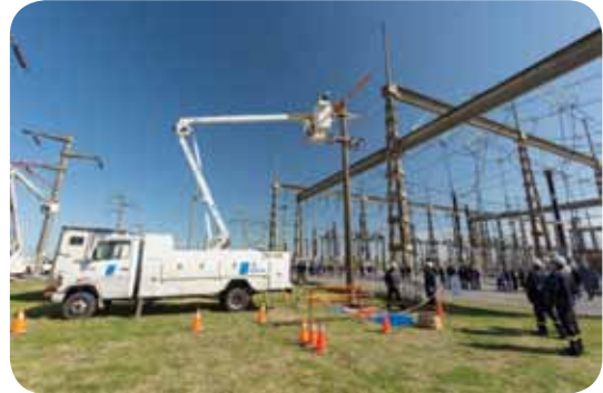
En la Estación Transformadora General Rodríguez se demostraron trabajos con diferentes medidas de tensión
