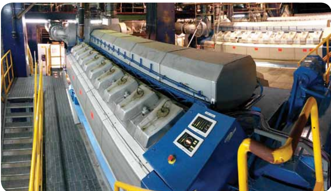
El primer moto generador de la Central Costanera
