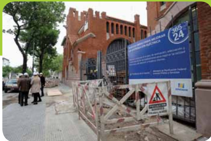
La Subestación Pérez Galdós está ubicada detrás de la Usina del Arte.
