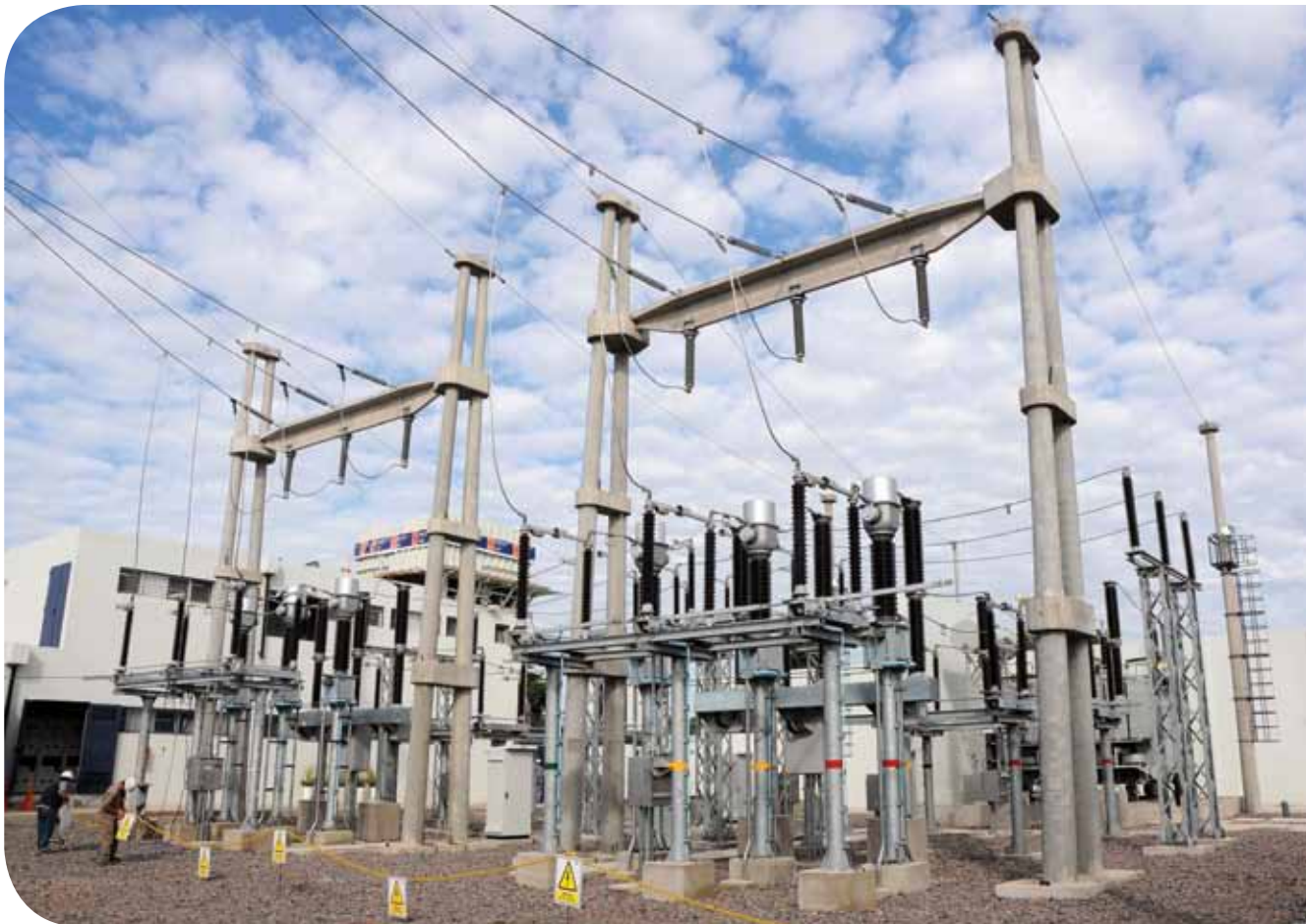
Nueva Subestación Sur, ubicada en la localidad de Los Hornos.
