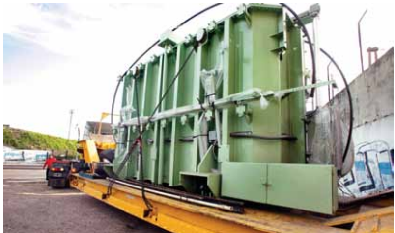
Llegada del nuevo transformador, oriundo de Córdoba, a la Subestación Pompeya.
