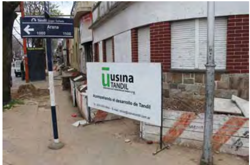
Las tareas se realizaron desde la avenida Colón, entre Pellegrini y Machado, en pleno centro de la ciudad.
