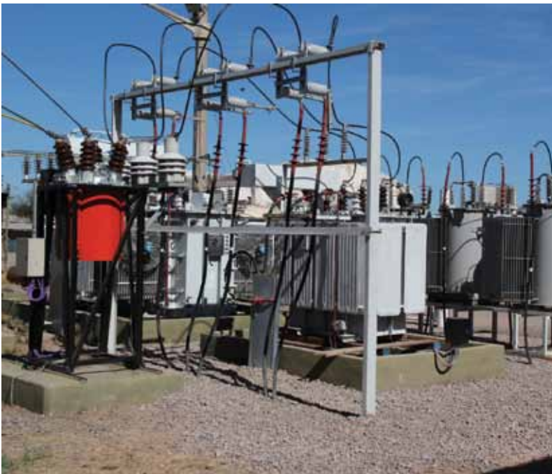
La Estación Transformadora de Chepes, recientemente repotenciada.
