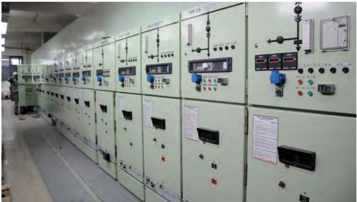
La Subestación cuenta con un tablero de comando de última tecnología.
