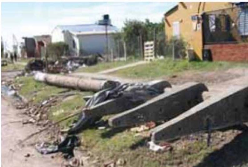
Los postes de hormigón de las líneas de media tensión también fueron afectados.
