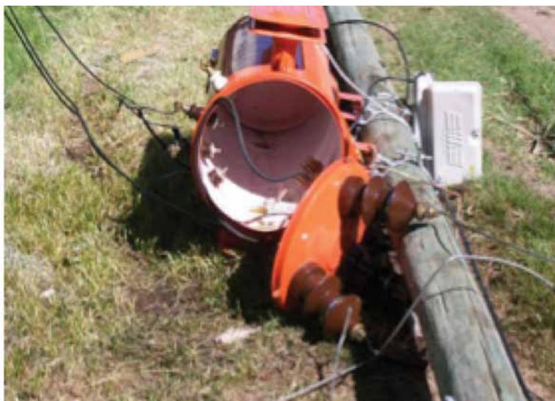
La fuerza del viento arrasó varios transformadores como el que se ve en la imagen.
