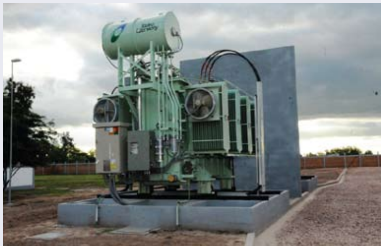
Nuevo Transformador de 33 / 13.2 KV de la Estación Transformadora N° 3 de Presidencia Roque Sáenz Peña
