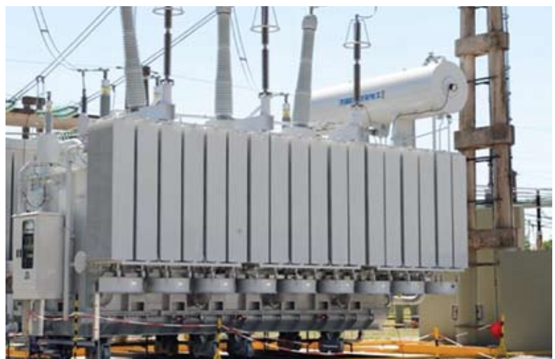
Una vista del nuevo transformador
