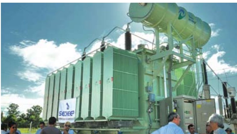
Nuevo Transformador de 132 / 33 Kv Instalado en la Estación Transformadora N° 5
