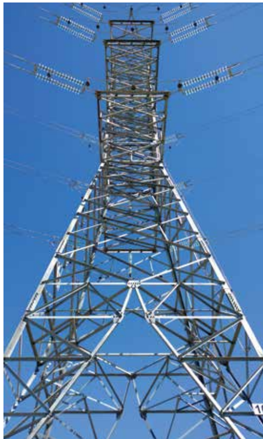
Línea de Alta Tensión a Estación Transformadora Gerdau 220 kV.
