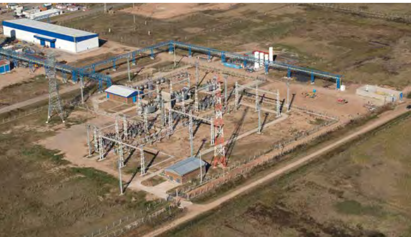
Estación Transformadora Gerdau, Pérez, Departamento Rosario.
