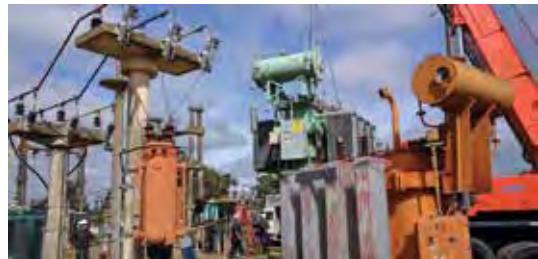
La repotenciación de la estación transformadora beneficia a más de 4.500 usuarios.
